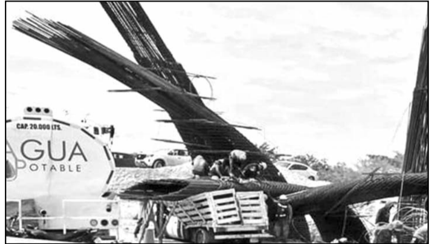
Las estructuras de hierro de un puente levantado como parte de las obras del Tren Maya, en el Tramo 6, se desplomaron y cayeron sobre un vehículo
