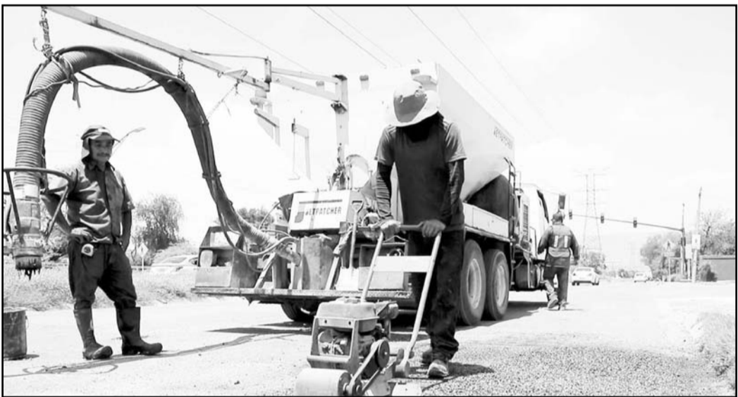
Tras las fuertes lluvias registradas varias calles quedaron muy afectadas.
