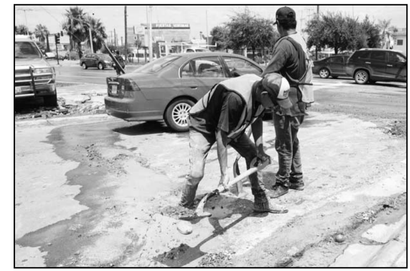
Esto se hace ante lo maltratado que se encuentra el pavimento
